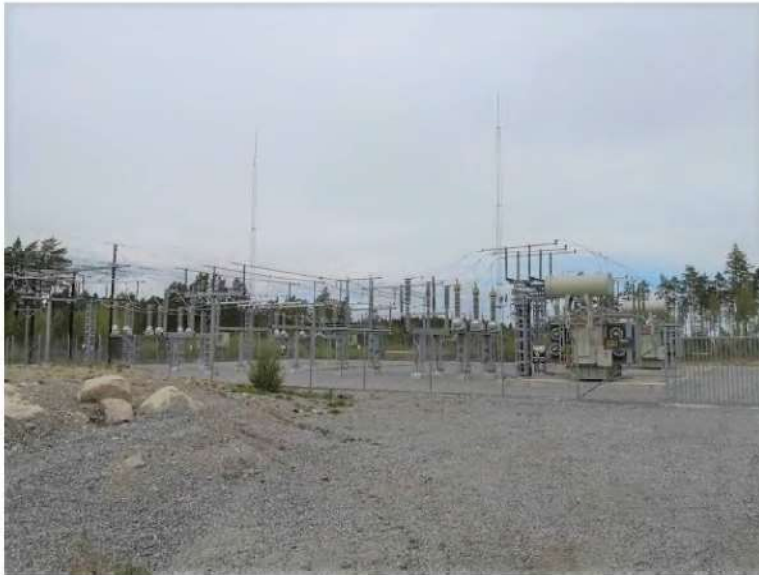
Figur 9. Exempel på ställverk.
