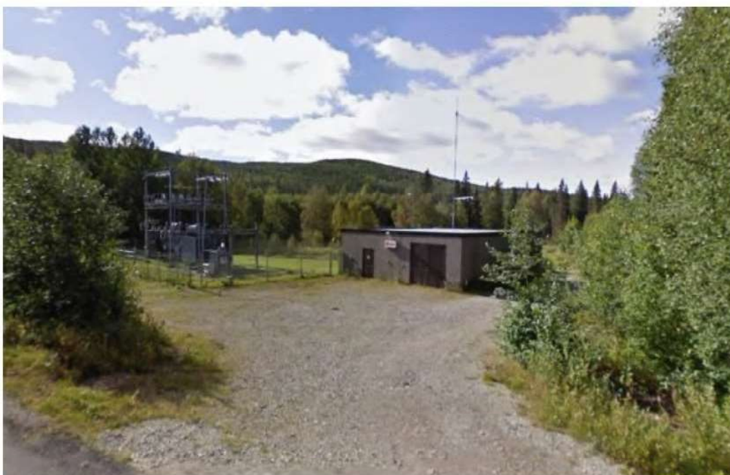
Figur 7. Befintligt ställverk som ska avvecklas.
